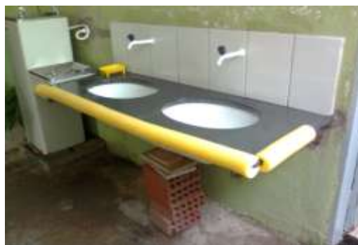
Figura 13. Proteção nas quinas da pia.
