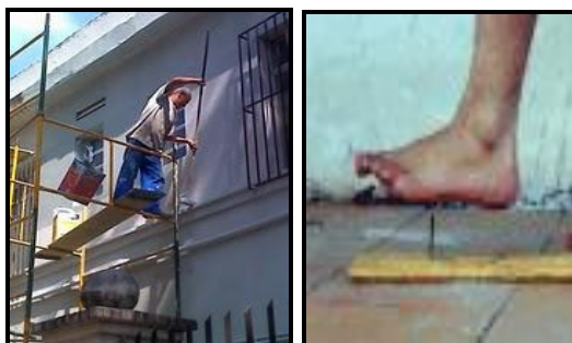
Figura 1: Exemplo de ato inseguro e ambiente inseguro. Fonte: Coord. de Seg. do Trabalho – CEFET/RJ, 2010.
