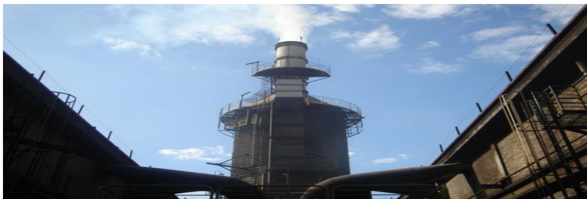
Figura 2 – Foto de uma das três torres de lavagem dos gases existentes na fábrica.
